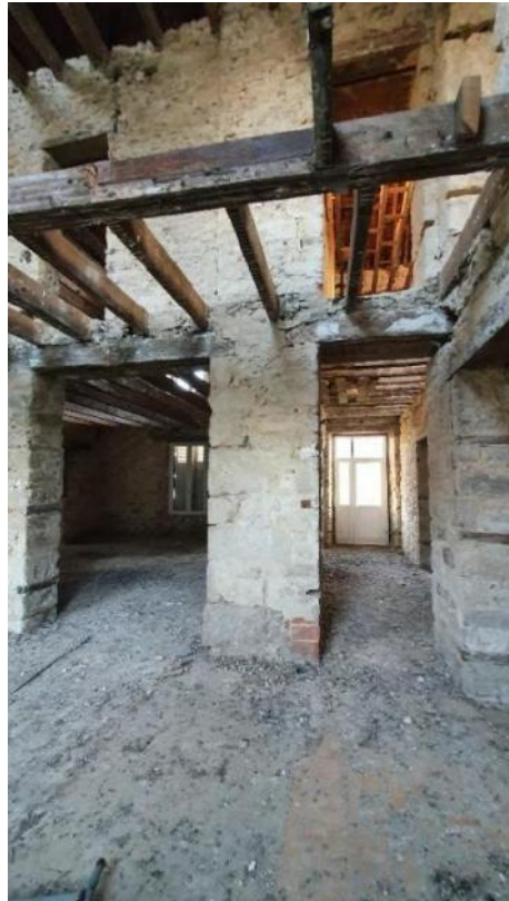
Illustration n°8. Intérieur du bâtiment principal de l'ensemble immobilier (Source : diagnostic flash ECR environnement p.4)
